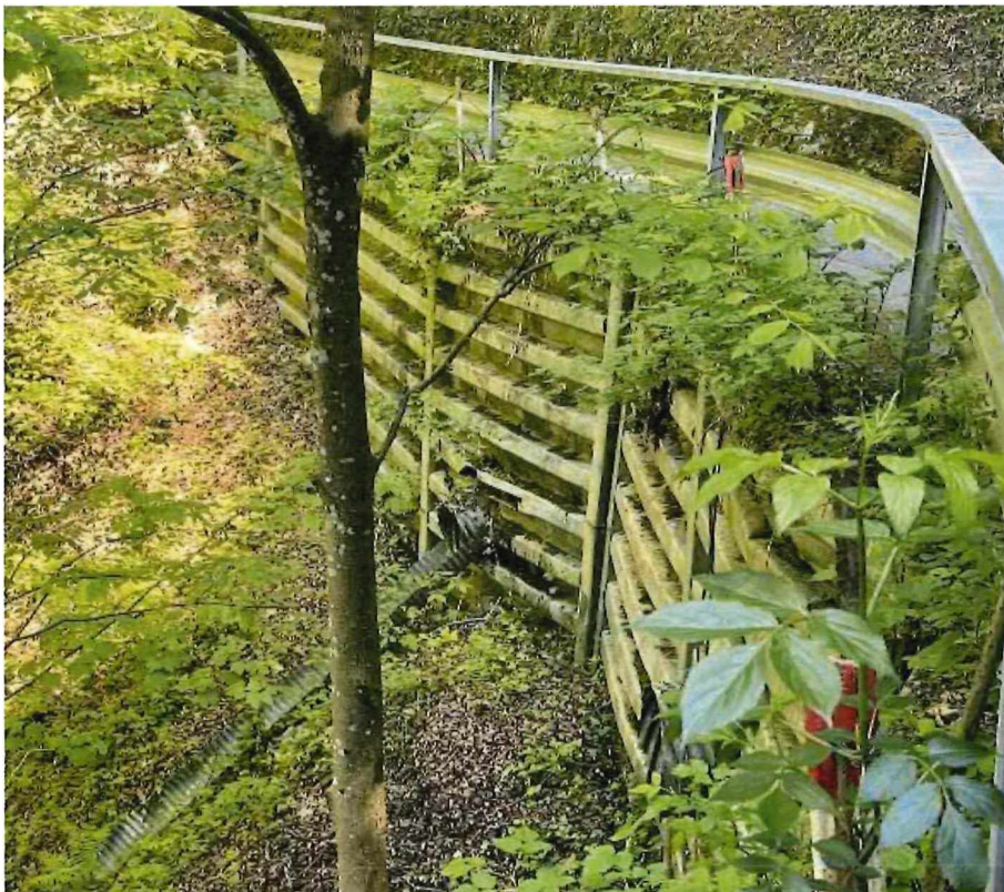
Abbildung 2: Stark deformierter Armco-Kasten
