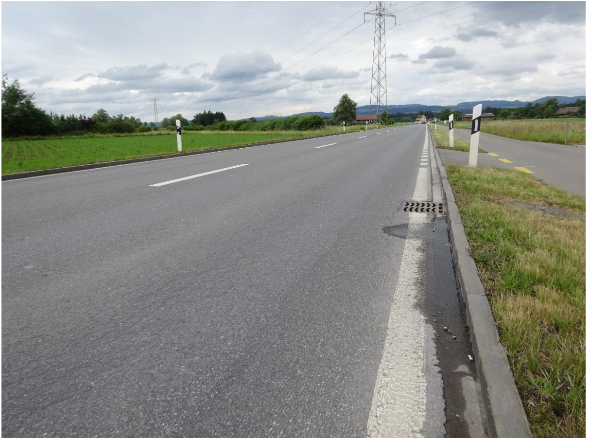
Die Sinserstrasse in Hünenberg weist Belagsschäden auf und wird im Juli 2020 saniert.
