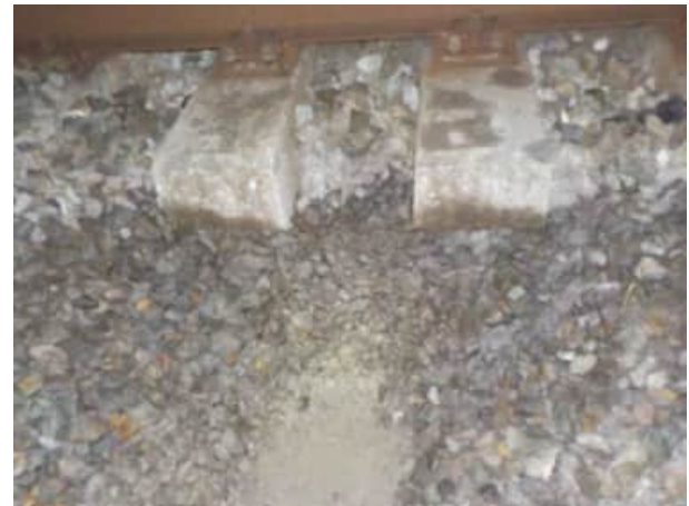
Bild 14: W 1, km 23.725 (Bereich seitliche Schiebung): Schotter am Schwellenkopf gering bis mittelmäßig (S1-S2) verschmutzt, wirksam stopf- und reinigbar
