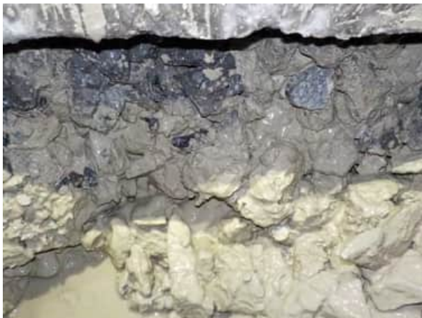
Bild 9: W1, km 23.689: Schotter in Gleismitte ab UK Schwelle verlehmt (S4), weder stopf- noch reinigbar
