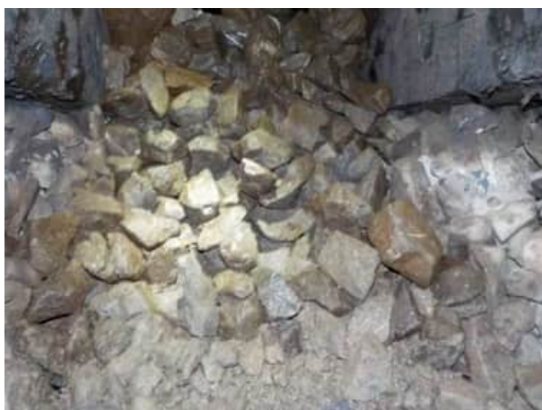
Bild 65: Gleis 92, km 25.060 : Schotter in den Schienenbereichen allenfalls mittelmäßig (S2) verschmutzt, wirksam stopf- und reinigbar
