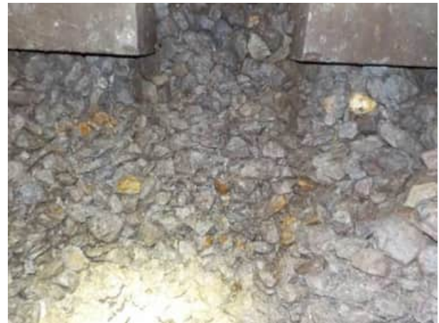
Bild 20: W 1, km 23.725 (Bereich seitliche Schiebung): Schotter am Schwellenkopf bis 60 cm unter SwOK gering bis mittelmäßig (S1-S2) verschmutzt, darunter verlehmt (S4)
