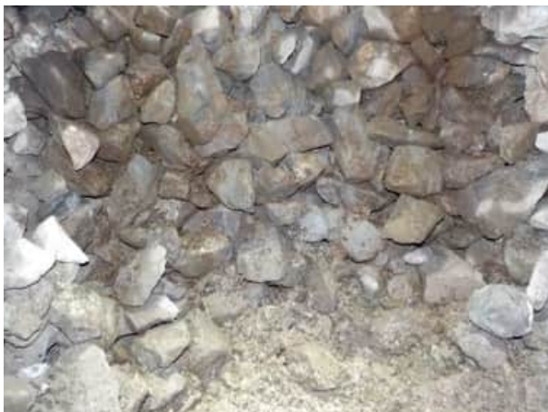
Bild 47: Gleis 92, km 24.850: Schotter in den Schienenbereichen allenfalls mittelmäßig (S2) verschmutzt, wirksam stopf- und reinigbar
