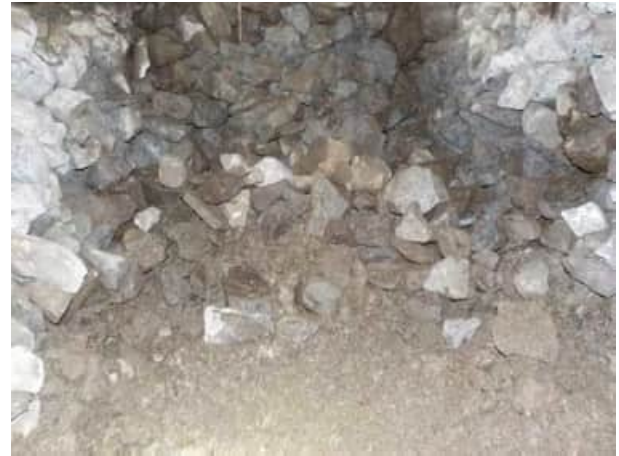
Bild 44: W8/9, km 24.815, Ablenkung: Schotter in den Schienenbereichen mittelmäßig (S2) verschmutzt, wirksam stopf- und reinigbar
