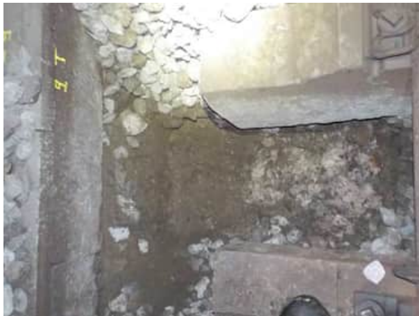
Bild 1: Gleis 11, km 23.674 (Tunnel): Blick auf den Schlitz im linken Randbereich ab Schwellenkopf
