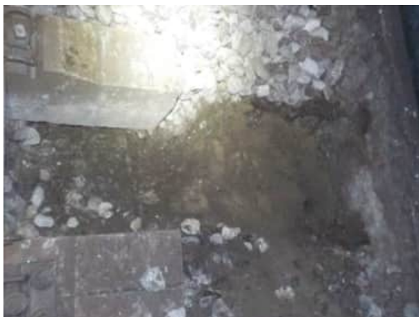
Bild 3: Gleis 11, km 23.674 (Tunnel): Blick auf den Schlitz im linken Randbereich ab Schwellenkopf
