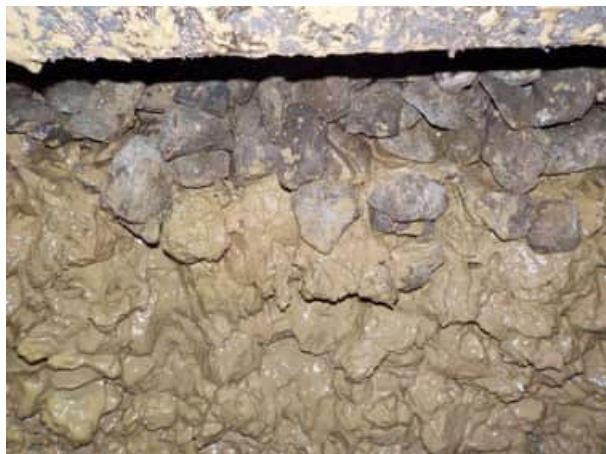
Bild 89: Gleis 325, km 25.770: Schotter ab 35 cm unter SwOK verlehmt (S4); weder wirksam stopf- noch reinigbar
