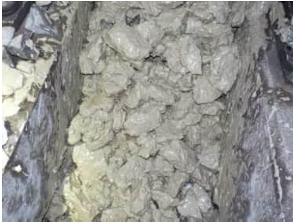
Bild 7: W1, km 23.689: Schotter im rechten Schienenbereich ab UK Schwelle verlehmt (S4), weder stopf- noch reinigbar
