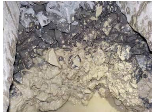
Bild 10: W1, km 23.689: Schotter im rechten Schienenbereich ab UK Schwelle verlehmt (S4), weder stopf- noch reinigbar
