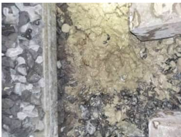
Bild 11: W1, km 23.689: im linken Randbereich sind ebenfalls Verlehungen bzw. eine geringe Lehmschicht vorhanden
