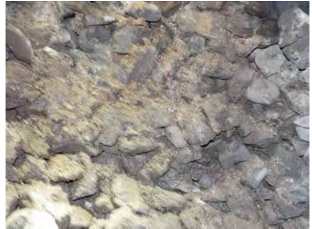
Bild 50: Gleis 92, km 24.900 : Schotter in den Schienenbereichen allenfalls mittelmäßig (S2) verschmutzt, wirksam stopf- und reinigbar
