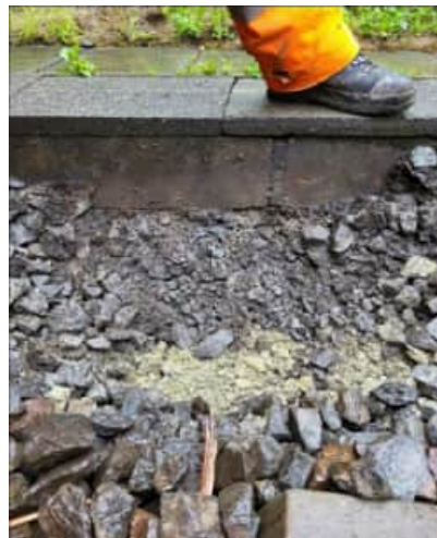
Gleis 11 Links, Lehm unter Kabelkanal, zwischen Gleis und Sicker- leitung. Ziemlich trocken.
