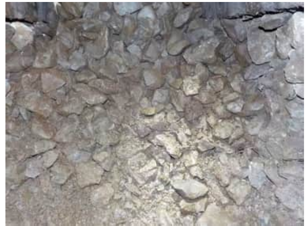
Bild 74: Gleis 91, km 25.300 : Schotter in den Schienenbereichen mittelmäßig (S2) verschmutzt, wirksam stopf- und reinigbar
