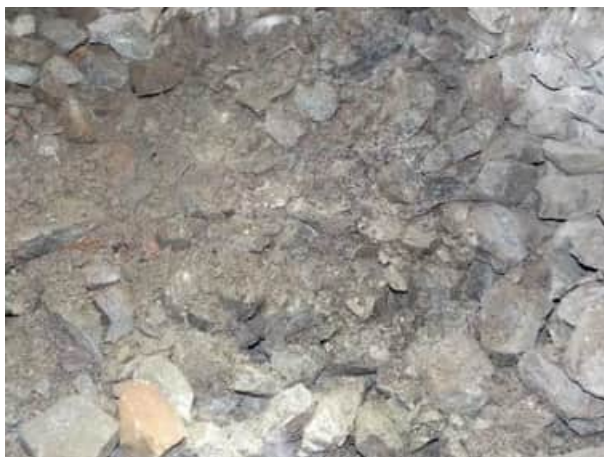
Bild 33: W6, km 24.706 : Schotter in den Schienenbereichen mittelmäßig (S2) verschmutzt, wirksam stopf- und reinigbar
