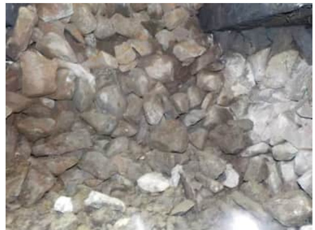
Bild 54: Gleis 92, km 24.970 : Schotter in den Schienenbereichen allenfalls mittelmäßig (S2) verschmutzt, wirksam stopf- und reinigbar
