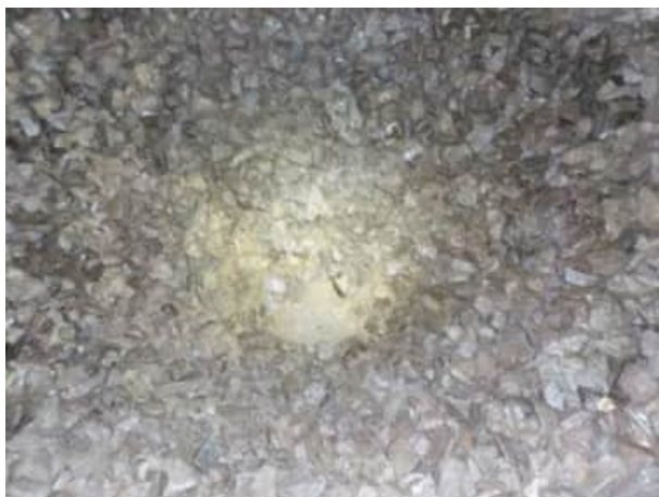
Bild 93: Gleis 425, km 25.830: Blick in den Aufschluss im Bereich der zukünftigen Diagonalen; der Unterbau ist lediglich geringmächtig (Schichtdicke 10 cm) und verlehmt
