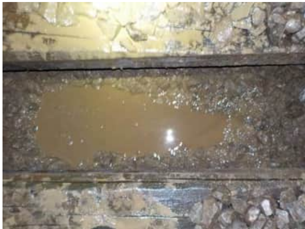
Bild 85: Gleis 91, km 25.400: Blick auf die Planie; aufgestautes Meteorwasser
