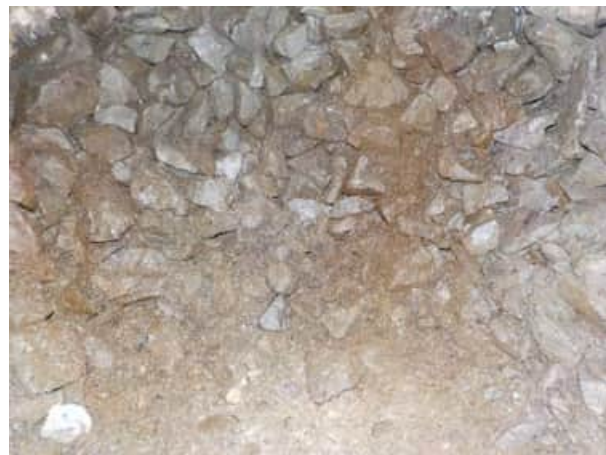
Bild 80: Gleis 91, km 25.400: Schotter in den Schienenbereichen mittelmäßig (S2) verschmutzt, wirksam stopf- und reinigbar
