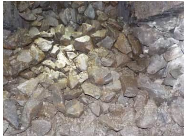
Bild 62: Gleis 91, km 25.055 : Schotter in den Schienenbereichen allenfalls mittelmäßig (S2) verschmutzt, wirksam stopf- und reinigbar
