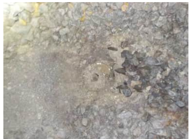
Bild 22: W 1, km 23.725 (Bereich seitliche Schiebung): Blick in den Aufschluss; kein typischer unterbau vorhanden, unterhalb einer geringmächtigen Mischzone steht feinkörniger Boden (Bodengruppe CM) an
