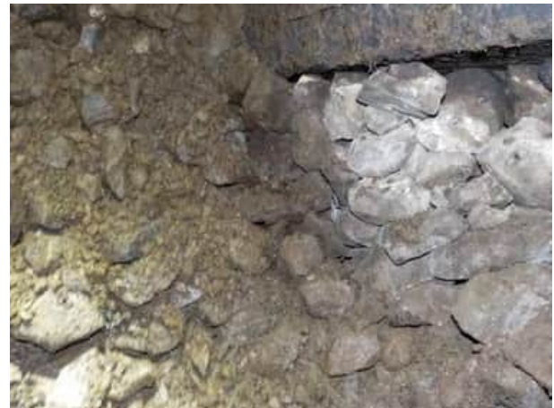
Bild 68: Gleis 91, km 25.170: Schotter in den Schienenbereichen mittelmäßig (S2) verschmutzt, wirksam stopf- und reinigbar
