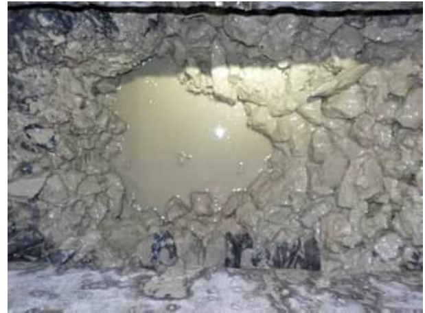
Bild 8: W1, km 23.689: Blick in den Aufschlusse; große Stauwassermengen im Schotterbett
