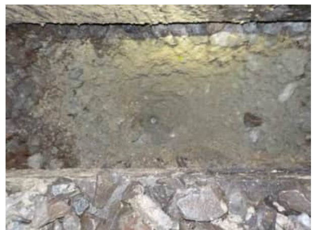
Bild 96: Gleis 325, km 25.830: Blick in den Aufschluss, der Unterbau besteht aus siltigem (verlehmt) Kies mit Sand (Bodengruppe GM, Schichtdicke lediglich 13 cm)
