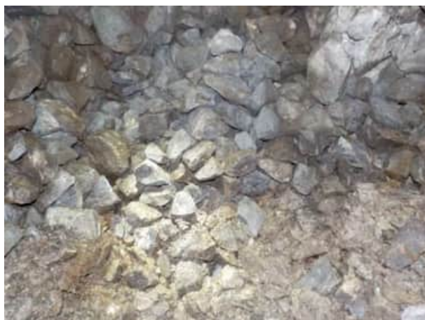
Bild 41: W9, km 24.815, Hauptstrang: Schotter in den Schienenbereichen allenfalls mittelmäßig (S2) verschmutzt, wirksam stopf- und reinigbar
