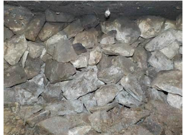
Bild 98: Gleis 425 km 25.890: Schotter in Gleismitte bis 35 cm unter SwOK allenfalls gering (S1) verschmutzt, gut stopf- und reinigbar
