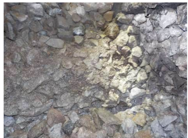
Bild 24: Gleis 21-425, km 23.815: Schotter in den Schienenbereichen mittelmäßig (S2) verschmutzt, wirksam stopf- und reinigbar
