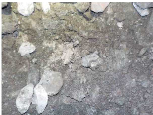
Bild 5: Gleis 11, km 23.674 (Tunnel): Schotter unter rechtem Schwellenkopf ab 35 cm unter SwOK verlehmt (S4)
