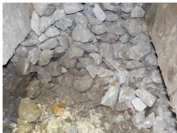
Bild 6: Gleis 11, km 23.674 (Tunnel): Schotter im Bereich der rechten Schiene ab 35 cm unter SwOK verlehmt (S4), darüber gering bis mittelmäßig (S1-S2) verschmutzt und reinigbar
