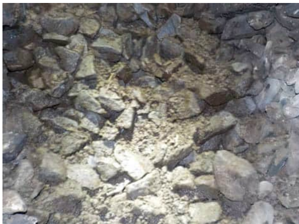
Bild 71: Gleis 92, km 25.170: Schotter in den Schienenbereichen allenfalls mittelmäßig (S2) verschmutzt, wirksam stopf- und reinigbar
