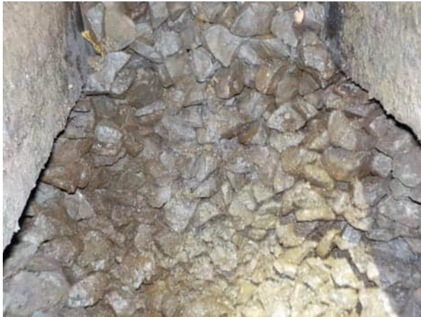
Bild 91: Gleis 425, km 25.830: Schotter in den Schienenbereichen allenfalls mittelmäßig (S2) verschmutzt, wirksam stopf- und reinigbar
