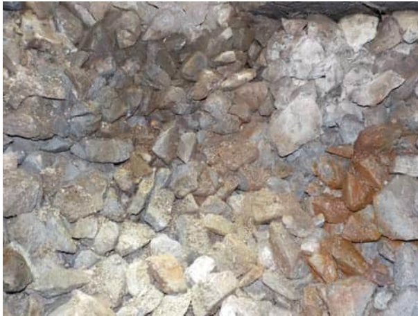
Bild 37: W7, km 24.767: Schotter in den Schienenbereichen allenfalls mittelmäßig (S2) verschmutzt, wirksam stopf- und reinigbar
