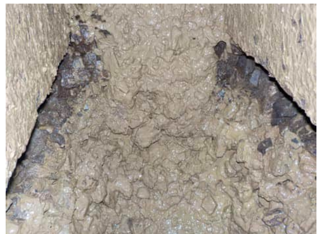
Bild 88: Gleis 325, km 25.770: Schotter ab 35 cm unter SwOK verlehmt (S4); weder wirksam stopf- noch reinigbar
