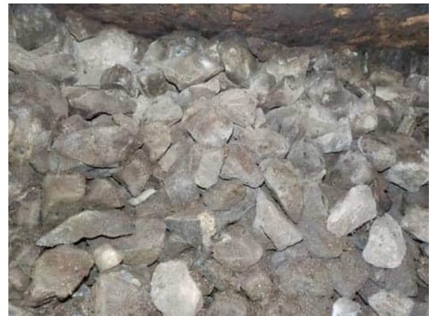
Bild 82: Gleis 92, km 25.400: Schotter in Gleismitte allenfalls gering (S1) verschmutzt, gut stopf- und reinigbar
