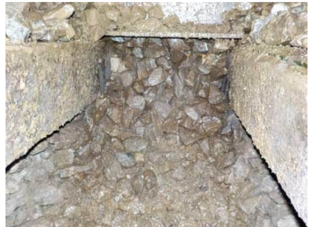
Bild 86: Gleis 425, km 25.770: Schotter in den Schienenbereichen mittelmäßig (S2) verschmutzt, wirksam stopf- und reinigbar
