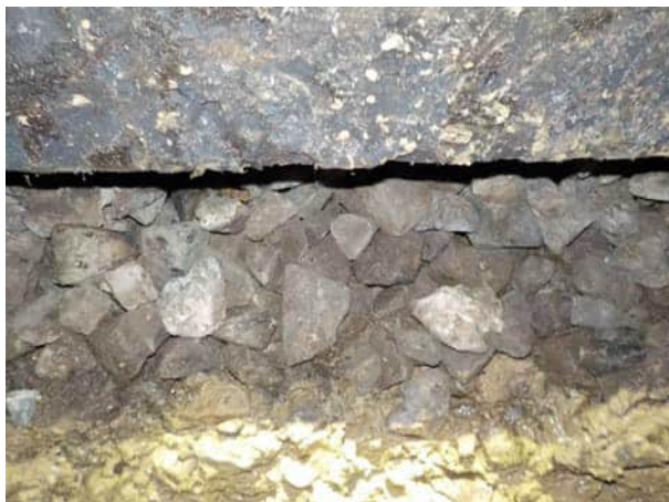
Bild 95: Gleis 325, km 25.830: Schotter ab 35 cm unter SwOK verlehmt (S4); weder wirksam stopf- noch reinigbar
