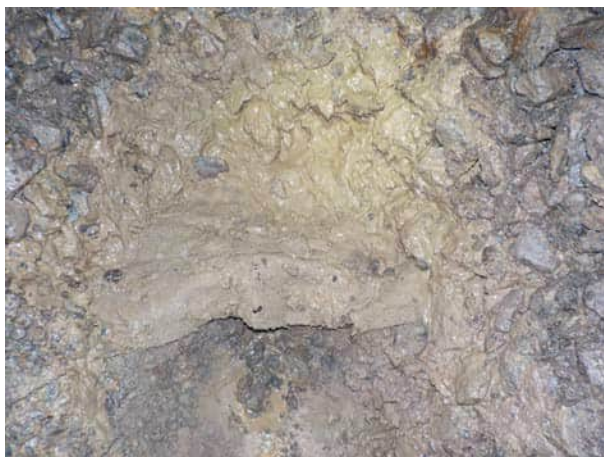
Bild 21: W 1, km 23.725 (Bereich seitliche Schiebung): das Vlies unterhalb des Schotterbettes läuft 30 cm neben dem Schwellenkopf aus
