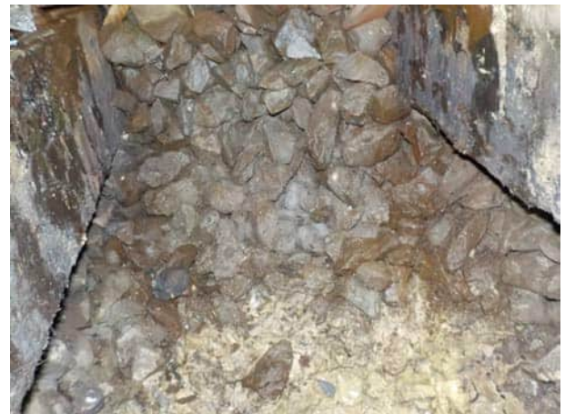
Bild 94: Gleis 325, km 25.830: Schotter ab 35 cm unter SwOK verlehmt (S4); weder wirksam stopf- noch reinigbar
