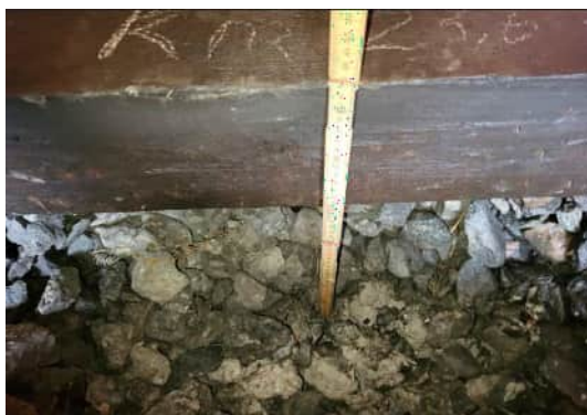
Litti, Gleis 11 Km. 23.674 Lage, im Tunnel Schwellen, Übergang Holz / Beton, Umbau Weiche 1 Befestigung, Ke / Ws Schotter 40 cm ab Schwellenoberkannte Schotter mit Lehm verschmutzt ab 40 cm
