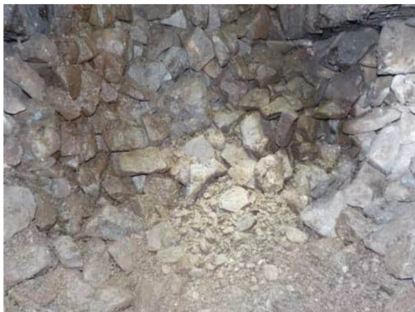
Bild 77: Gleis 92, km 25.290: Schotter in den Schienenbereichen allenfalls mittelmäßig (S2) verschmutzt, wirksam stopf- und reinigbar
