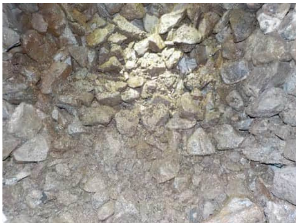
Bild 101: Gleis 325, km 25.890: Schotter in den Schienenbereichen allenfalls mittelmäßig (S2) verschmutzt, wirksam stopf- und reinigbar
