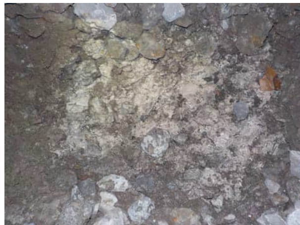
Bild 2: Gleis 62, km 26.200: Schotter im linken Schienenbereich ab 35 cm unter SwOK verlehmt (S4), darüber gering bis mittelmäßig (S1-S2) verschmutzt und reinigbar
